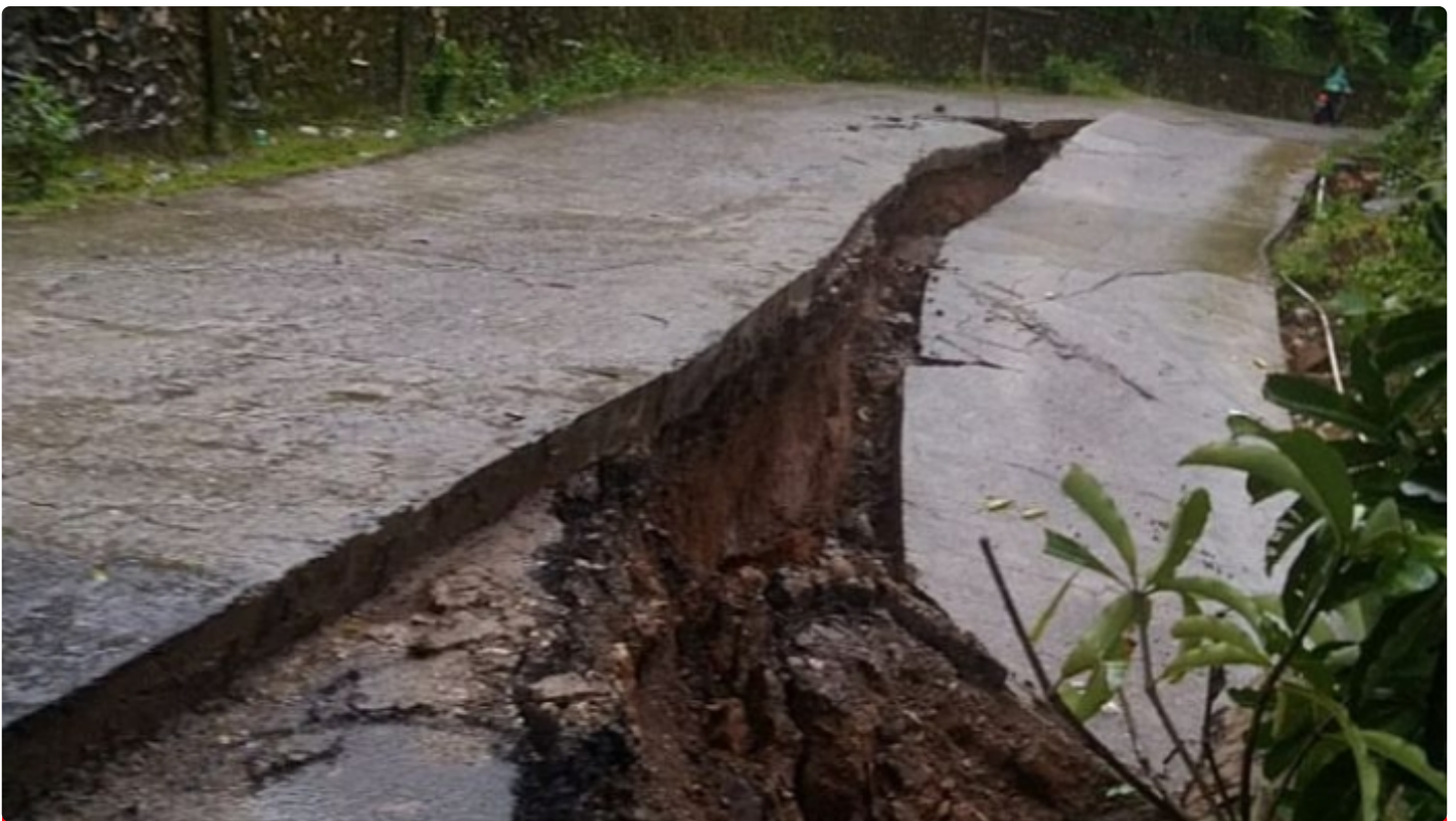
Akses Jalan Poros longsor, Kendaraan Warga Tondong Tallasa Tidak Bisa Lewat Lagi di Desa Malaka
